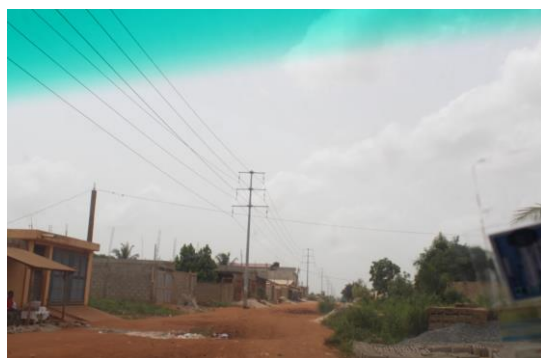
Vue de la ligne moyenne tension 20 KV double ternes
