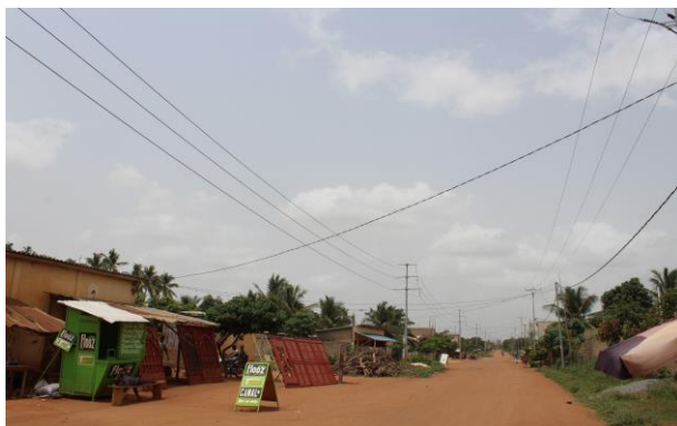
Vue de la ligne moyenne tension 20 KV
