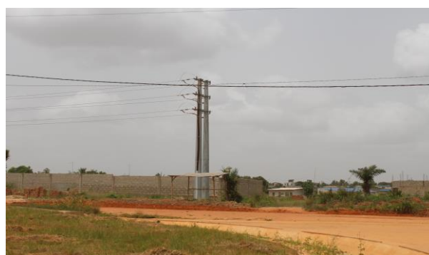
Vue de la ligne moyenne tension 20 KV double ternes
