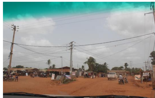
Vue de la ligne moyenne tension 20 KV double ternes
