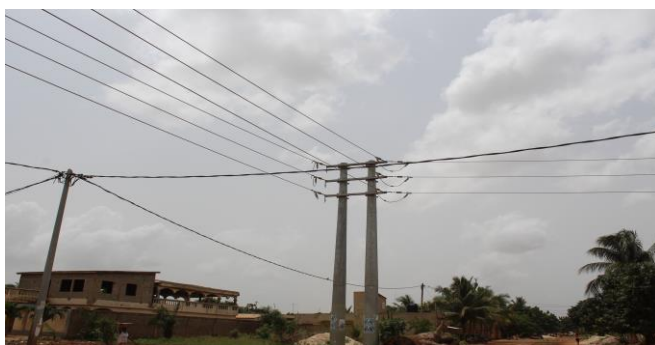
Vue de la ligne moyenne tension 20 KV double ternes
