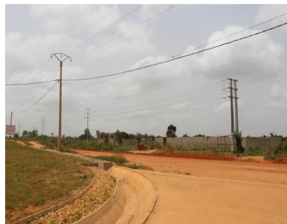
Vue de la ligne moyenne tension 20 KV double ternes
