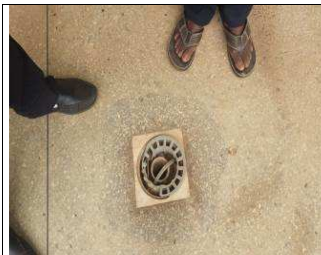
Photo 1 : siphon au sol en mauvais état
