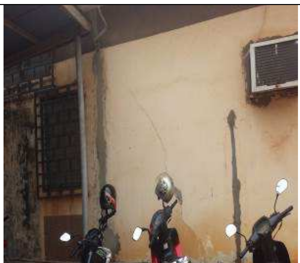
Photo 2 : fissures persistantes sur mur de façade côté Ouest
