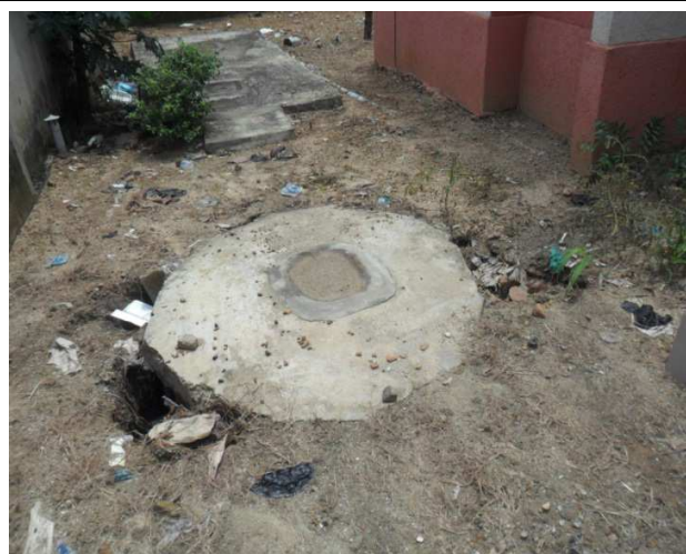
Photo 5: dépression au droit du puisard
