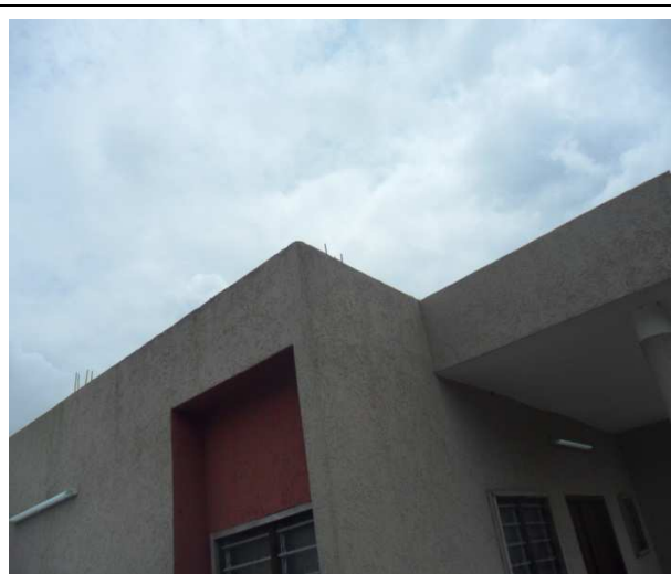
Photo 2: armature des poteaux au-dessus de la dalle laissé en attente sans protection
