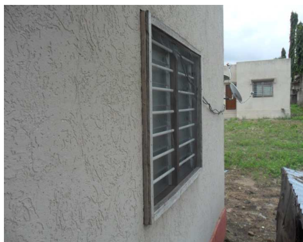
Photo 3: fenêtre persienne dépourvue de grille de protection
