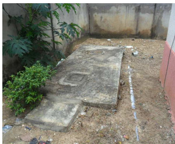
Photo 4: affleurement de tuyauterie d'évacuation des eaux vannes
