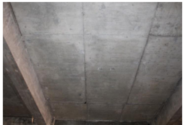
Présences des bavures sur les poutres
