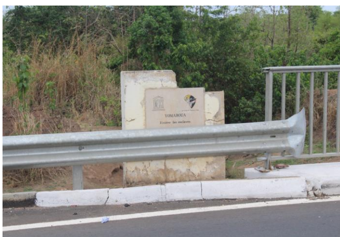
Glissières et guide roues endommagés
