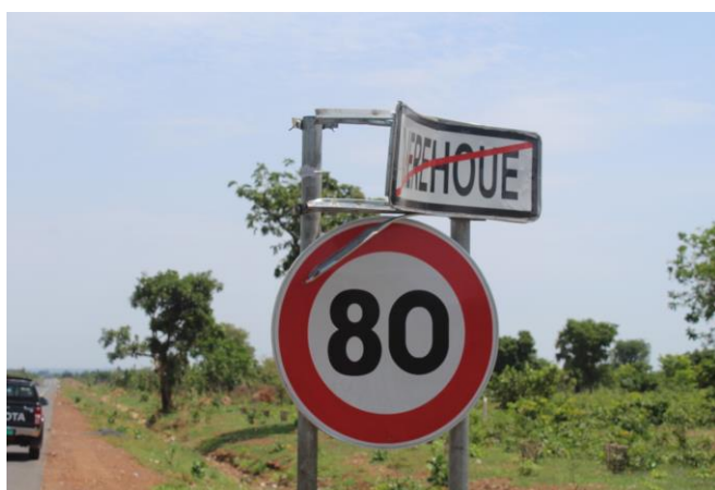
Les signalisations verticales endommagées par les usagers de route
