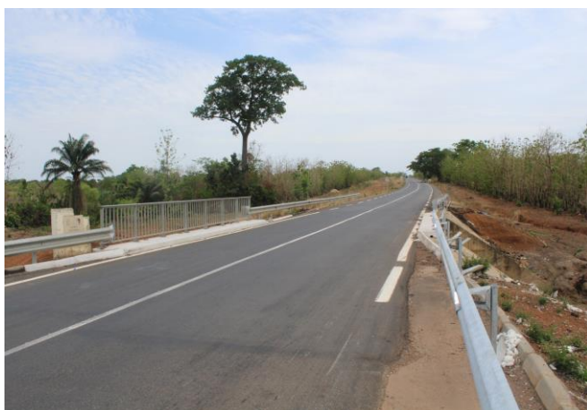
Glissières endommagées par dérapage des véhicules en excès de vitesse
