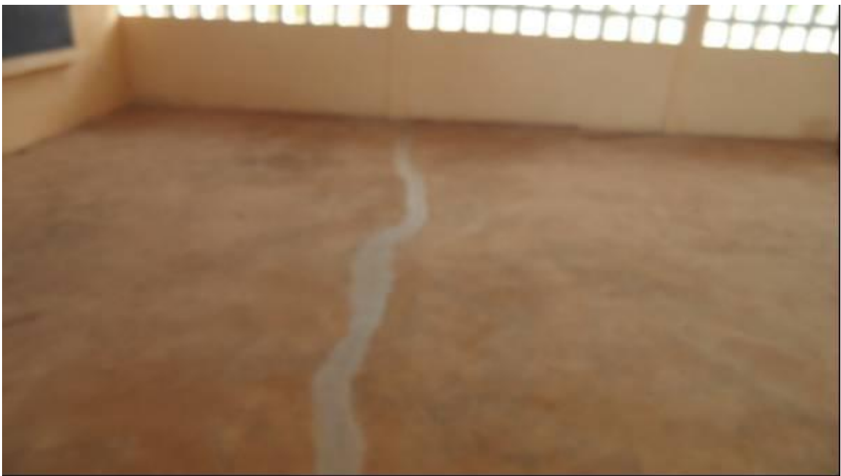
Fissures transversales dans les salles de classe, d'autres ont eu même de tentatives maladroites de correction
