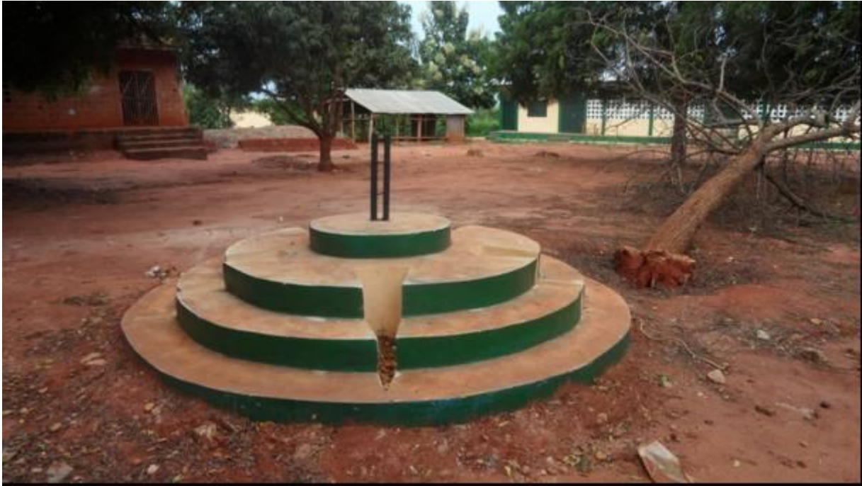
Le nettoyage s'impose avant réception, présence d'un arbre abattu pour construction mât
