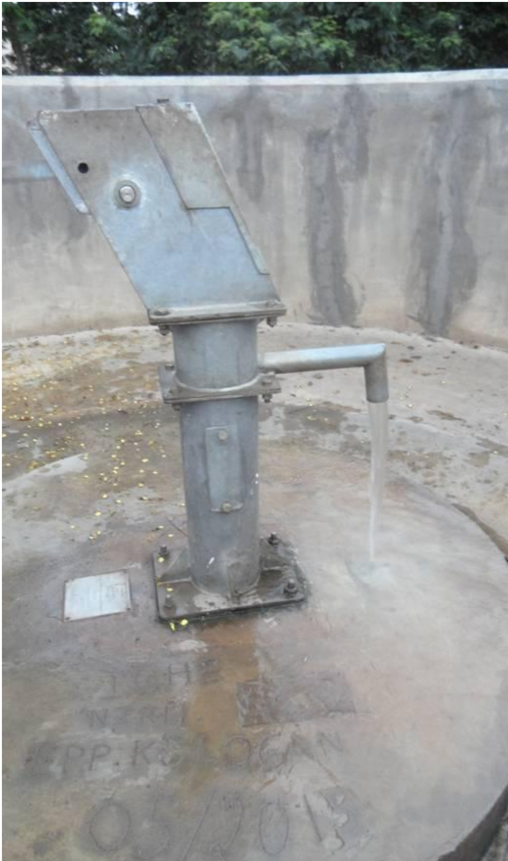
Noter les fissures verticales sur mur de protection (corrigées) à Kologan
