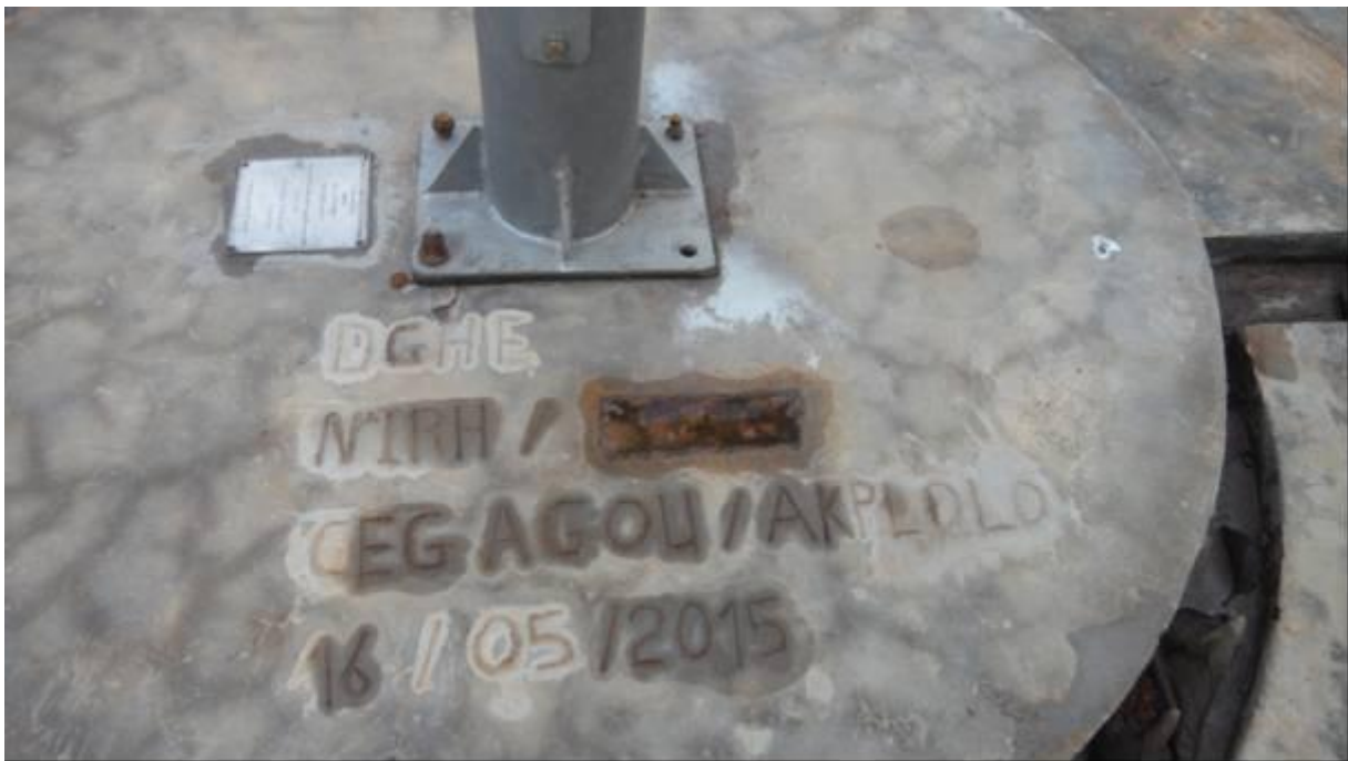
Noter les écrous défectueux des boulons de fixation à Agou Akpolo
