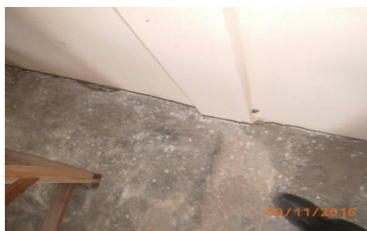
Fissure préjudiciable entre le mur et le dallage du sol (EPP SANDA KAGBANDA)
