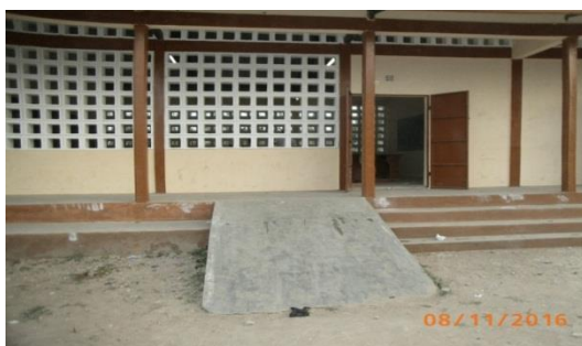
Rampe pour handicapé sans support de garde-corps (Lycée de DATCHA)
