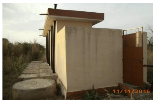
Blocs sanitaire sans indication du genre (EPP GNAMASSILE)
