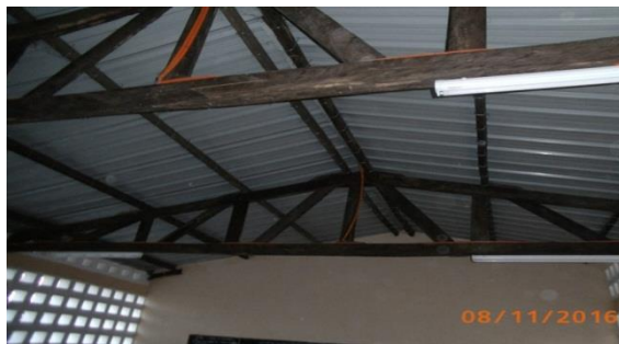
Insuffisance de traitement du bois de charpente (Lycée de DATCHA)
