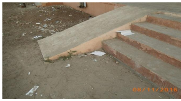
Rampe pour handicapé sans support et garde-corps (CEG KOFFITI)
