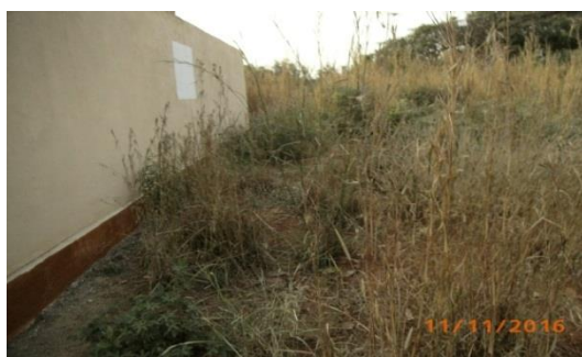
Bloc sanitaire envahit par les herbes (EPP GNAMASSILE)
