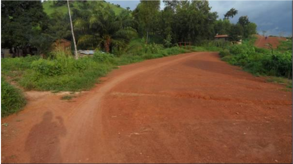
Absence de fossé ; l'eau venant de la montagne (gauche photo ) ravine
