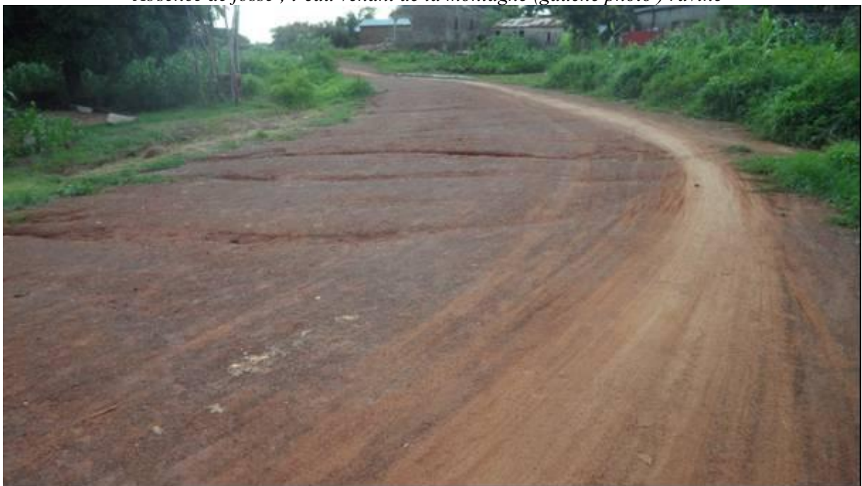
Absence de fossé ; ravines répétées
