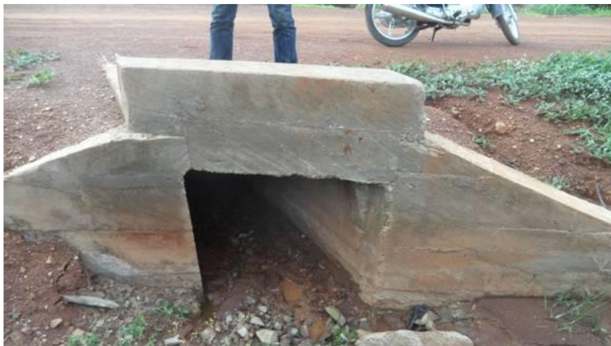
Dalot de section moindre que celle du marché
