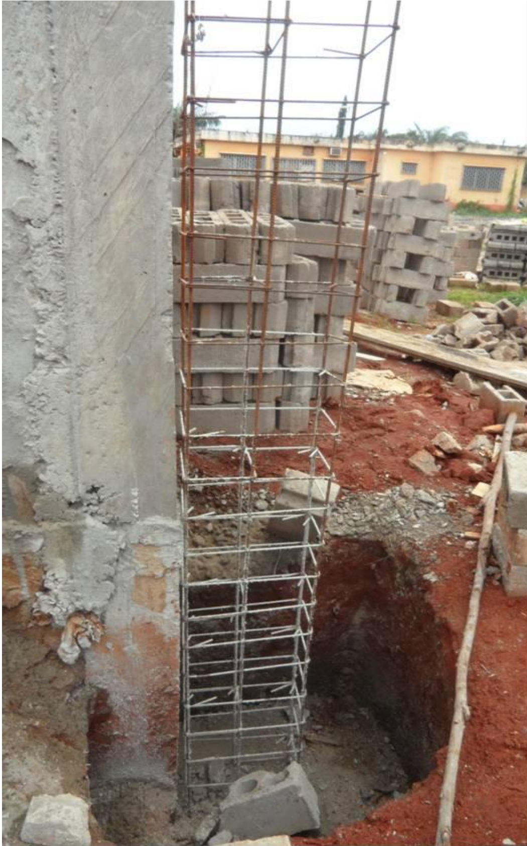
Qualité médiocre de bétonnage et des ajouts de poteau en cours d'exécution
