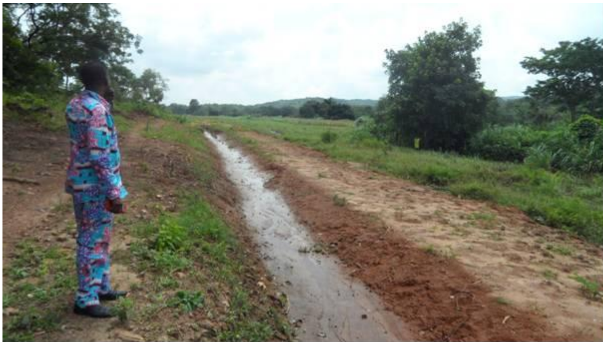
Site de Sara-Canal en terre au flanc de la montagne, risque de débordement
