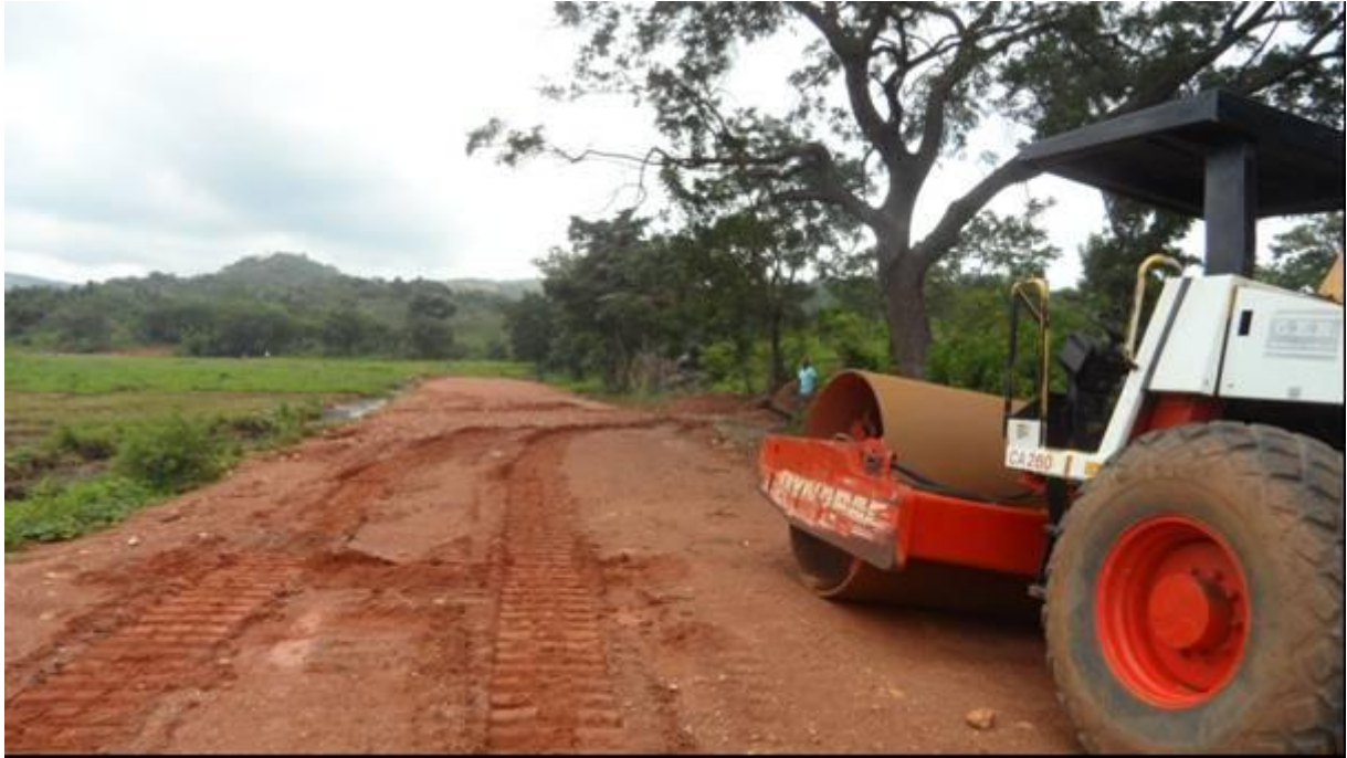
Site de Sara-Remblai d'emprunt non prévu au marché et en prélude au creusement du canal en terre
