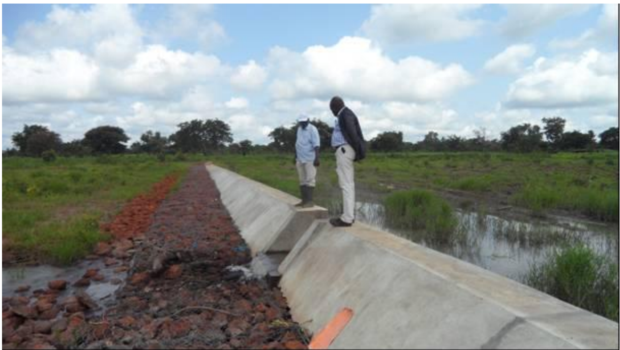
Ouvrage d'évacuation qui n'attend que la pose de palplanches sur le site de Tapoune
