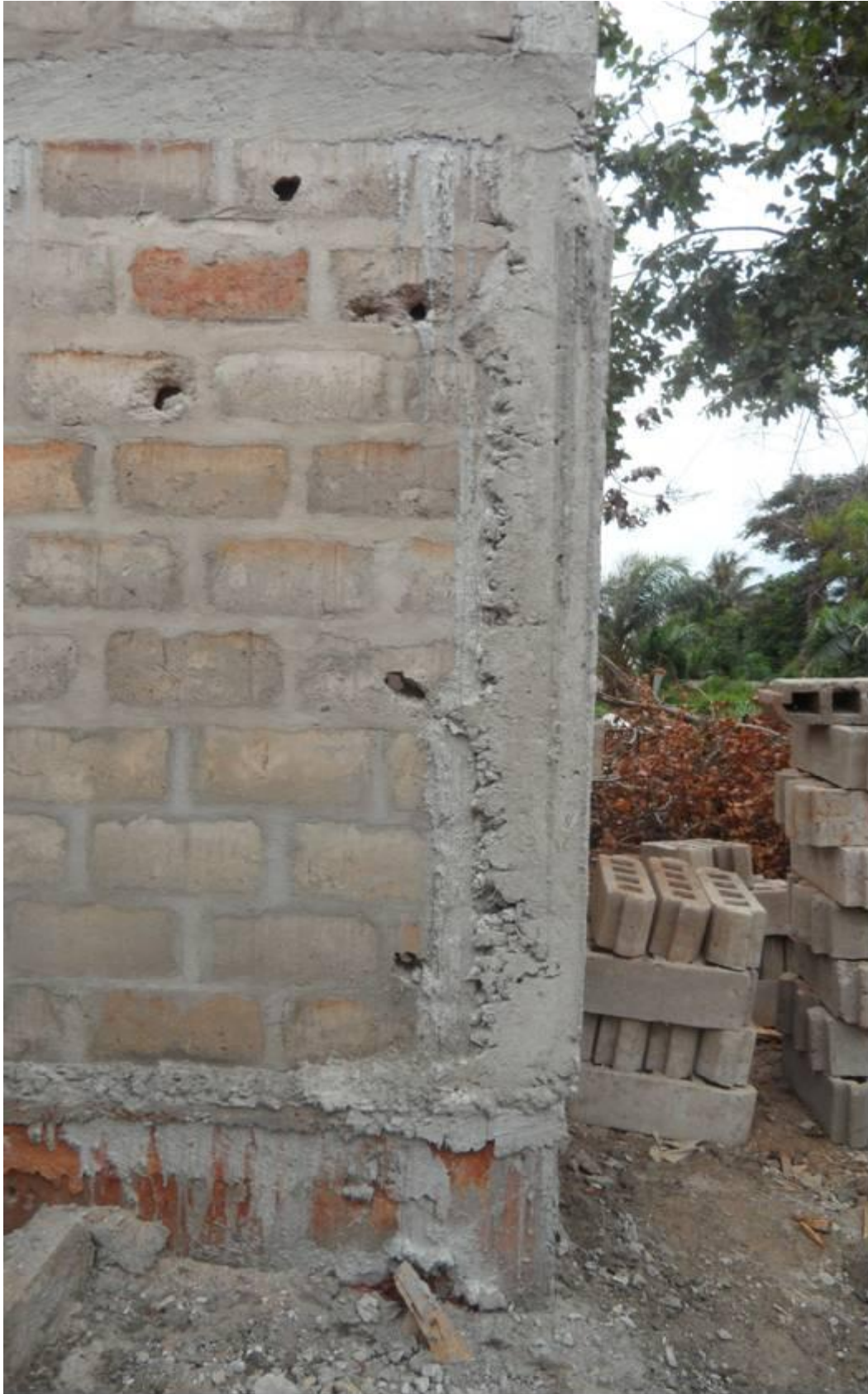
Bétonnage peu soigné
