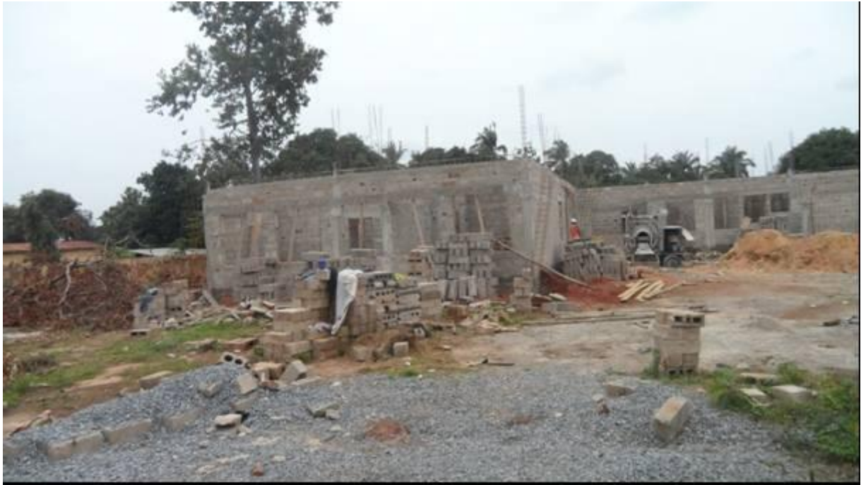
Niveau d'avancement des travaux ; chantier malpropre
