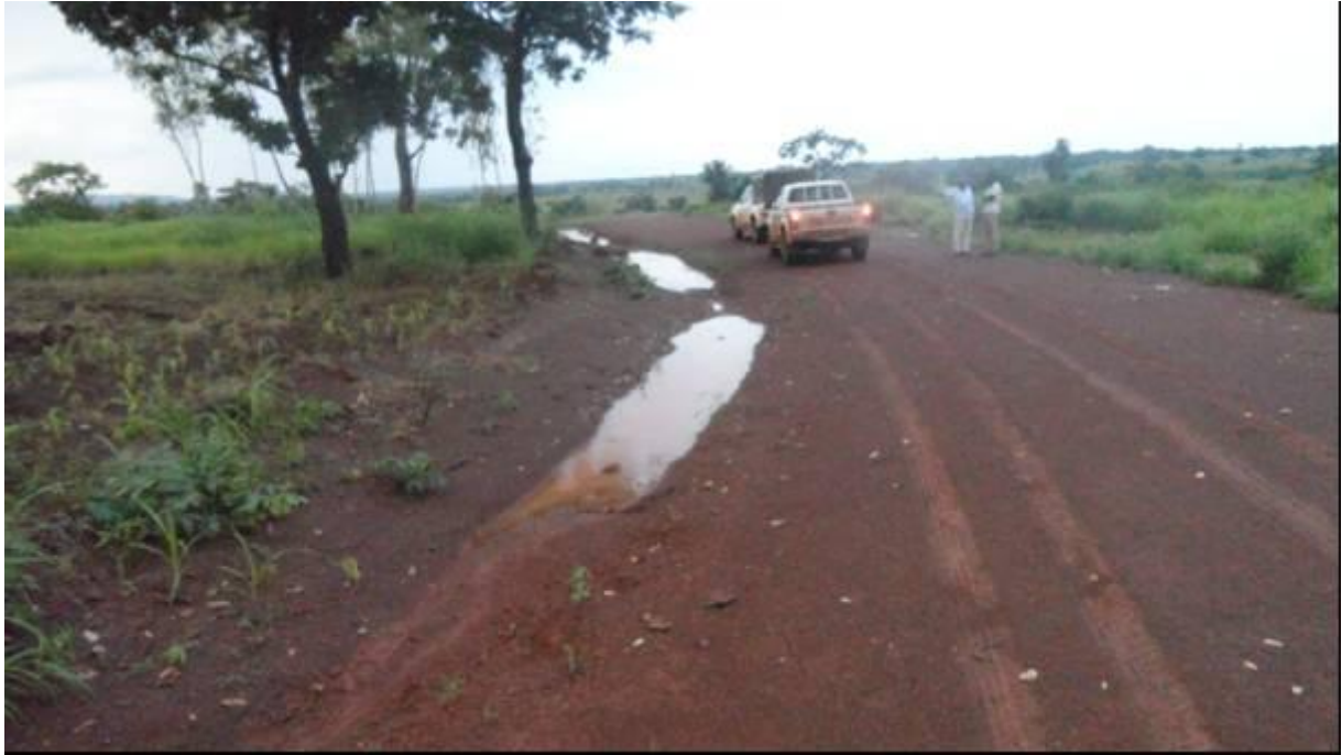
Fossés pas au gabarit et mal drainés
