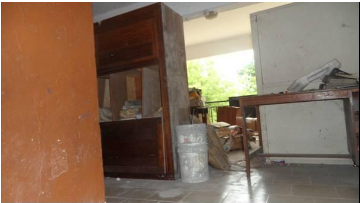
Mobiliers et dossiers de service abandonnés dans le hall même confondus avec les gamelles de travail des ouvriers
