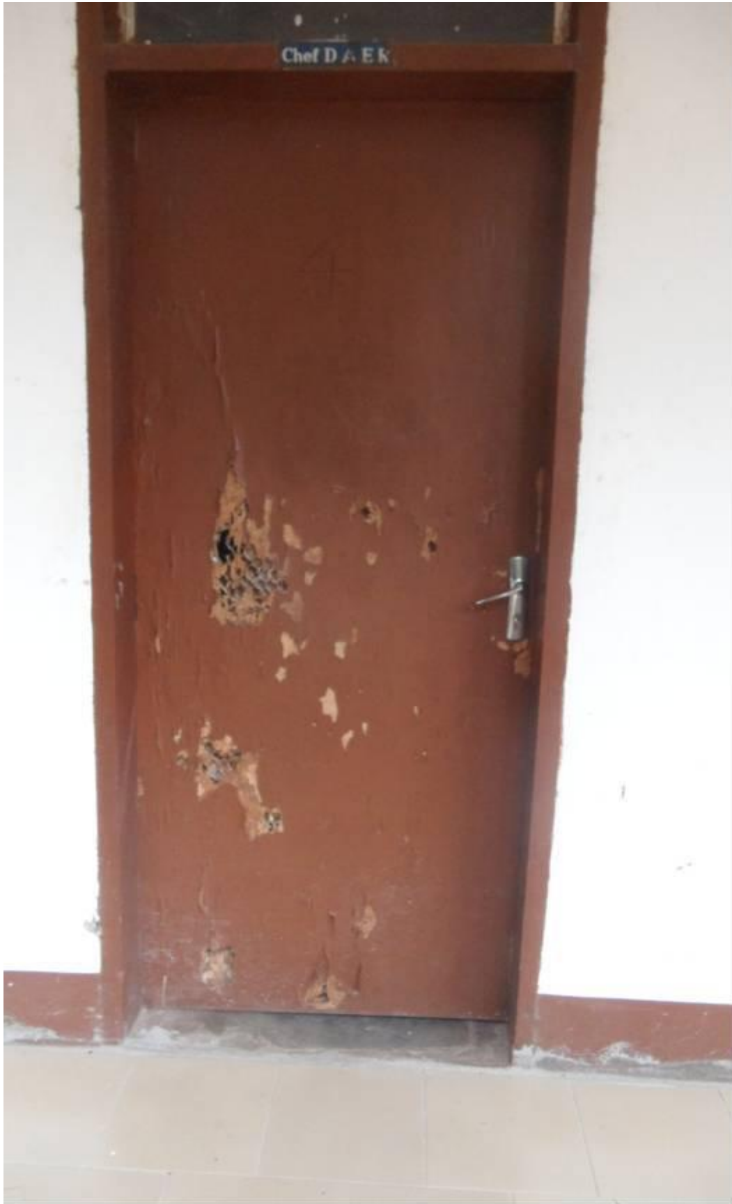
Des travaux restent, certains sont démarrés pas achevés
