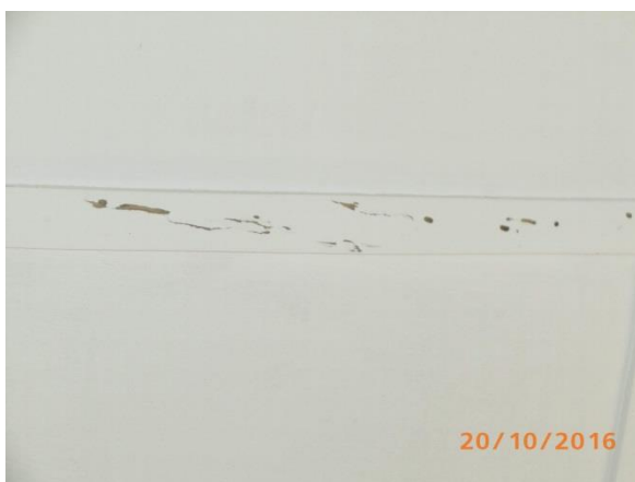
Le plafond souffre déjà de la présence des insectes destructeurs
