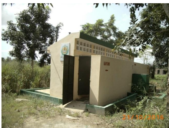
Bloc sanitaire de l'EPP Dagbossito envahi par les herbes
