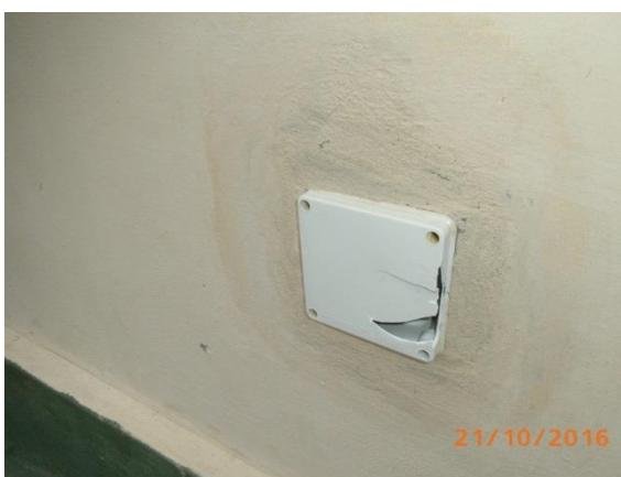
Une boîte de dérivation électrique vandalisée à l'EPP Dagbossito
