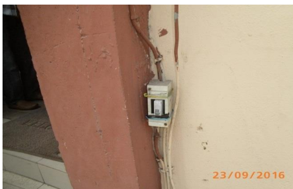
Module électrique exposé (Pose non conforme)
