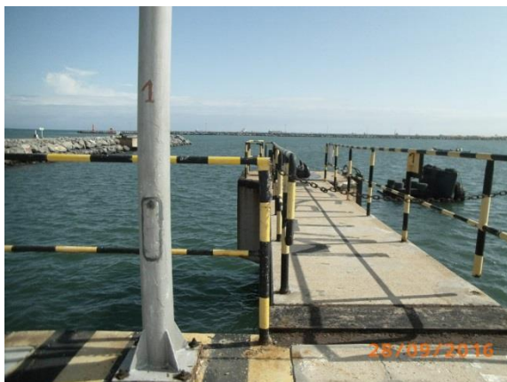
Cabestan N°4 démonté
