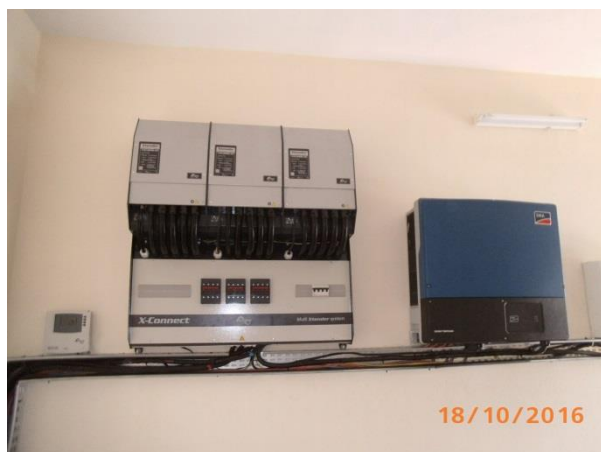
Equipements de transformation (DAVIE)
