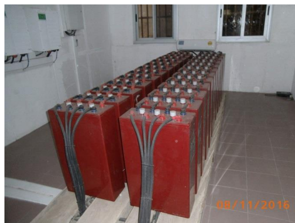
Vue des batteries d'accumulation (SOTOUBOUA)
