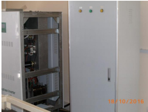
Onduleur chargeur triphasé défaillant (VODOUGBE)
