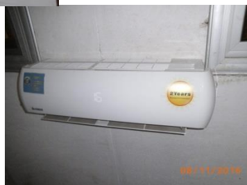
Equipements sous l'énergie photovoltaïque (SOTOUBOUA)
