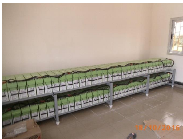
Vue des batteries d'accumulation (DAVIE)
