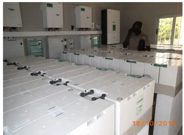
Vue des batteries d'accumulation (SANGUERA)
