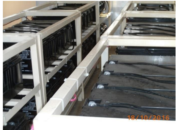
Vue des batteries d'accumulation (VODOUGBE)
