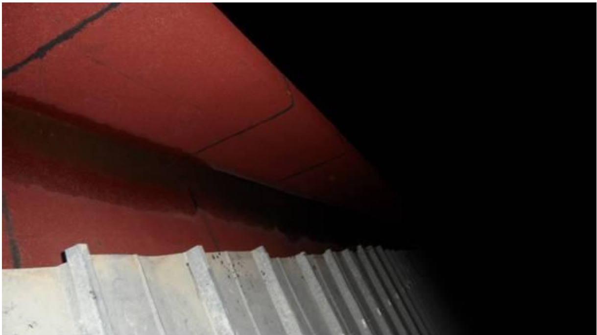
Présence remarquée de la stagnation de l'eau
