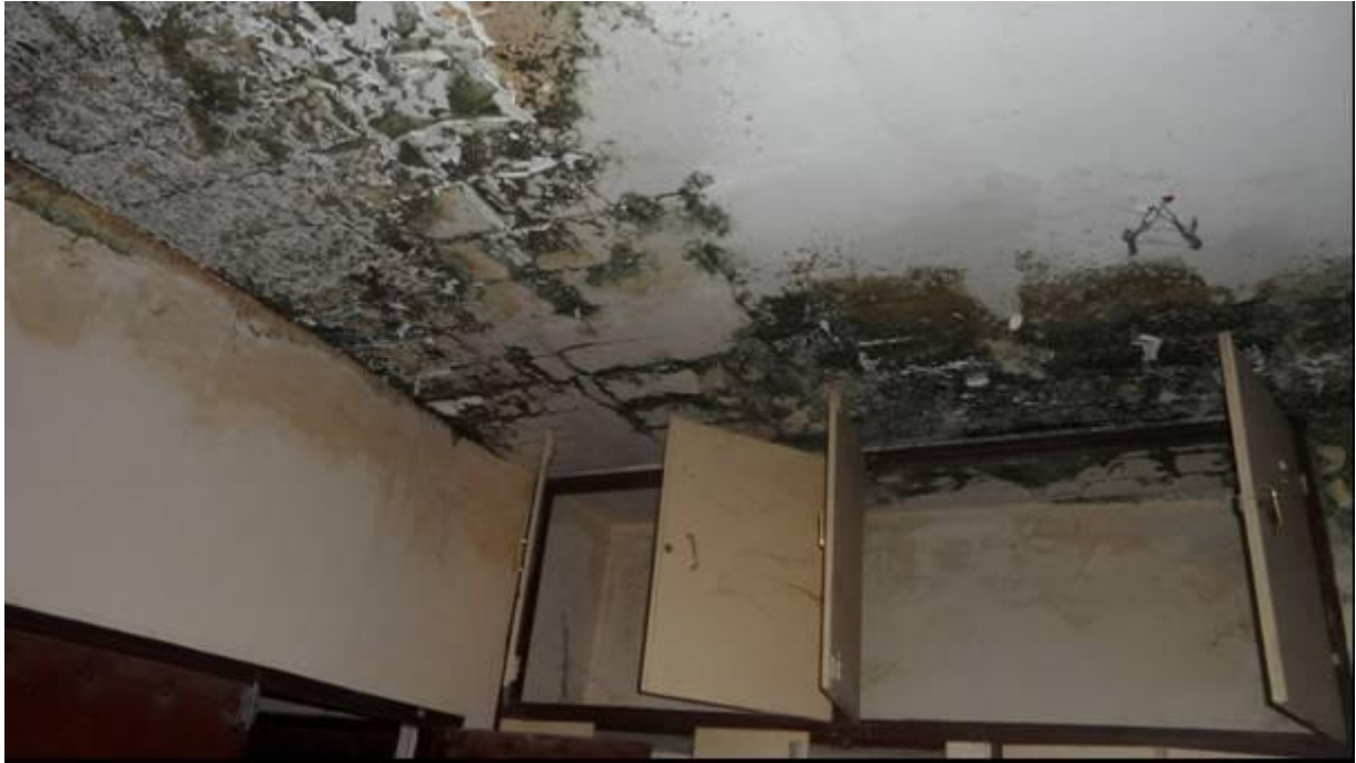
Trois vues successives du bureau dont le plafond et le mur sont détériorés du fait de l'infiltration
