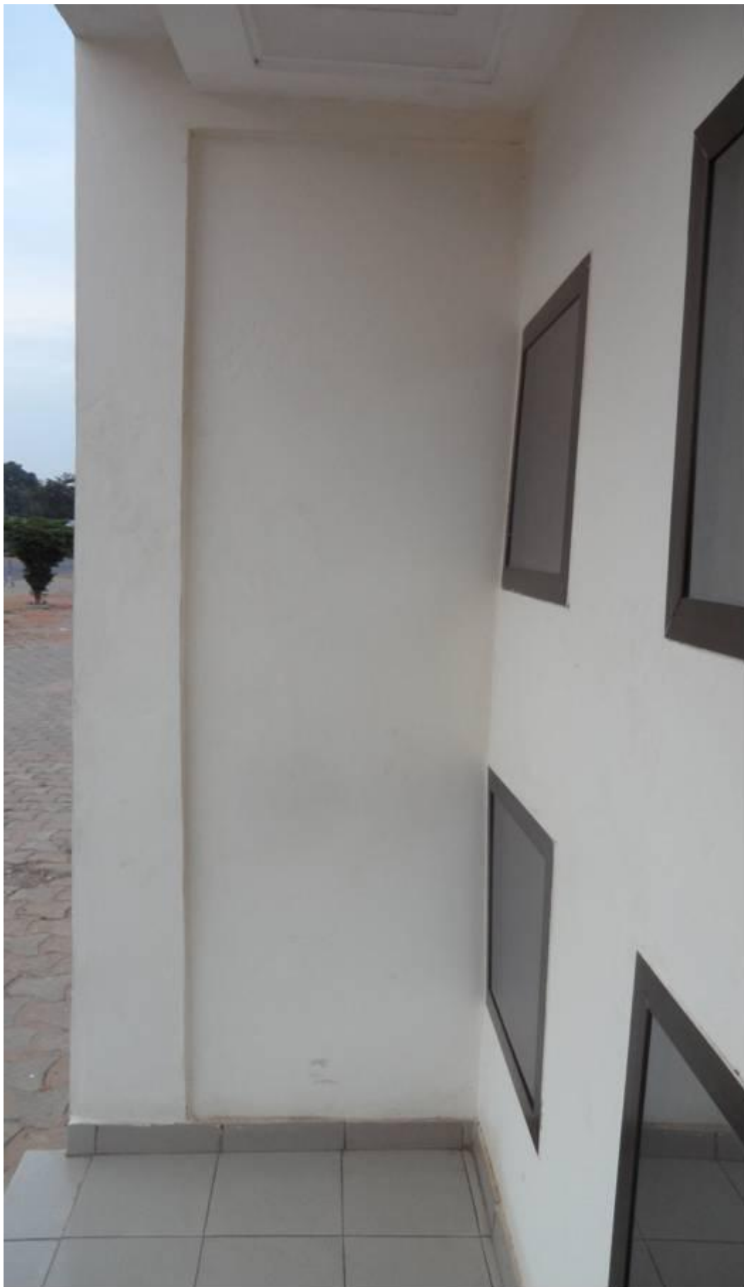
Le manque de rectitude du pan de mur avec les 4 panneaux vitrés
