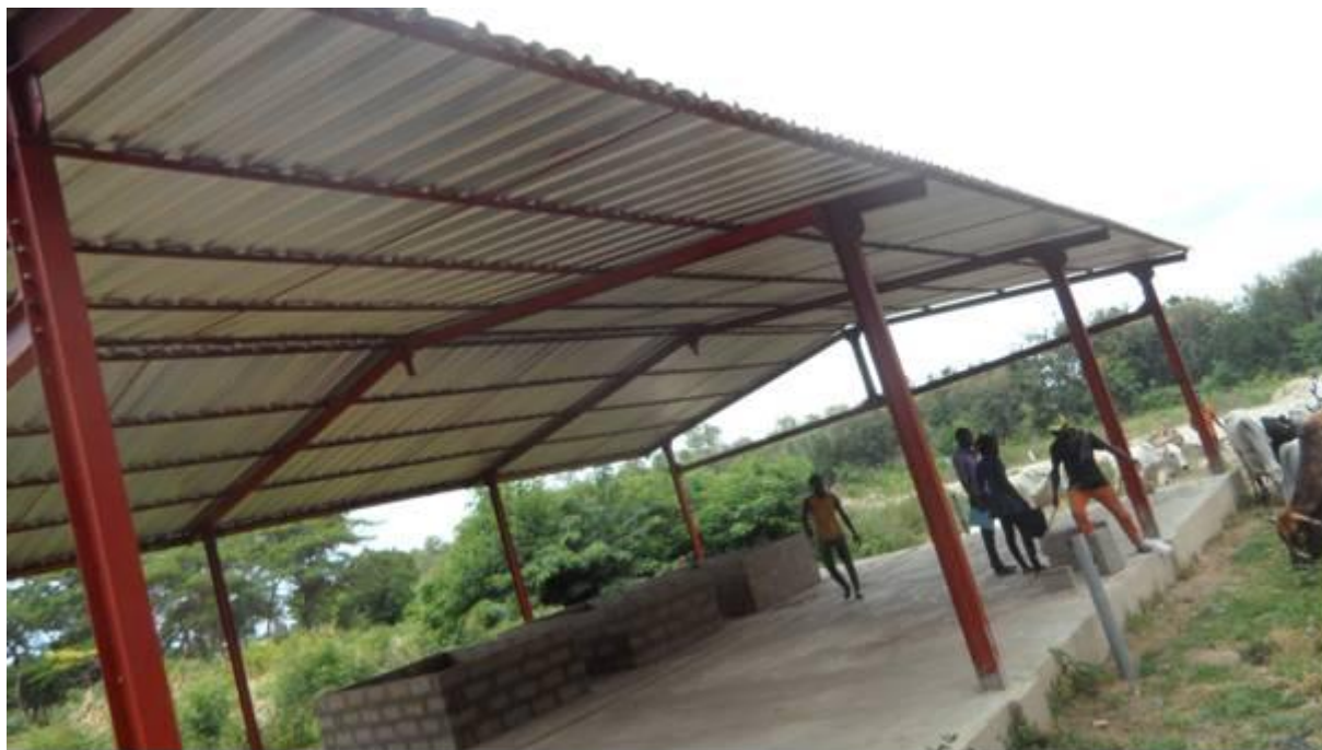
Constater l'absence de la gouttière à droite
