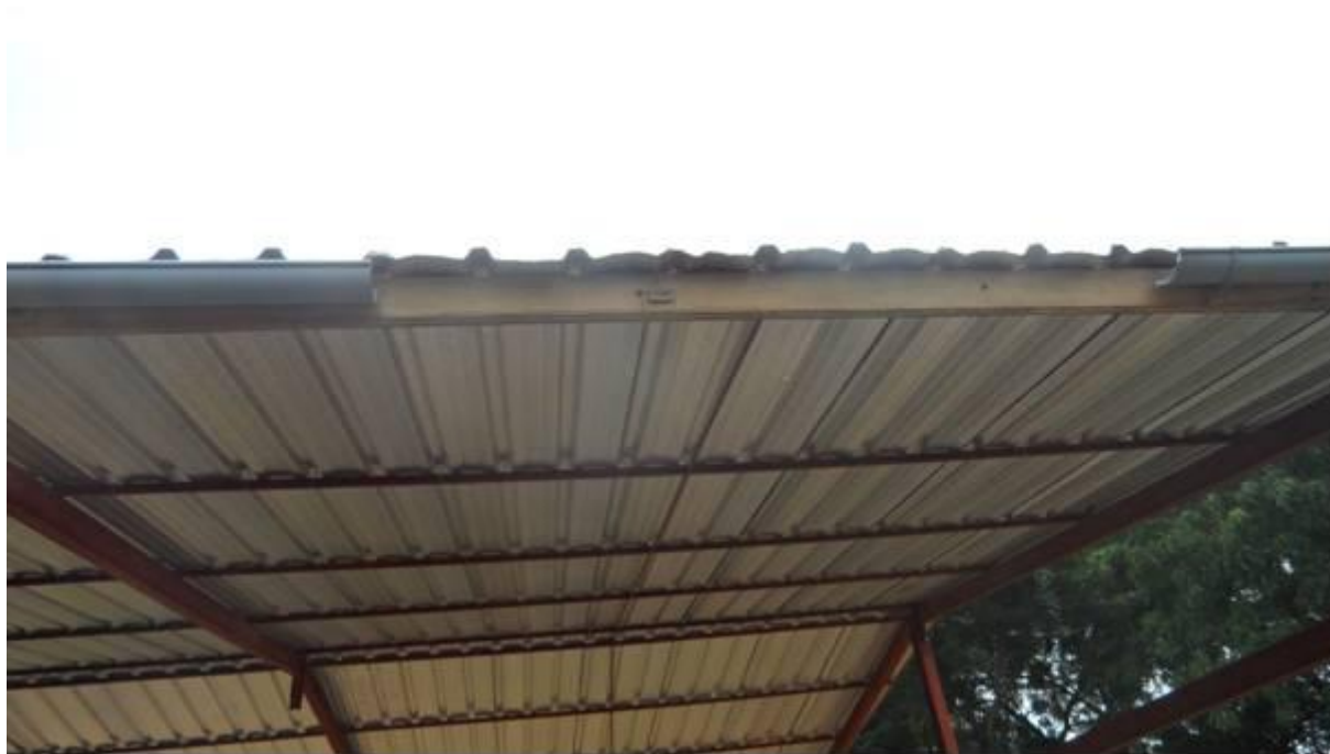
Gouttière tronquée au côté gauche de la toiture
