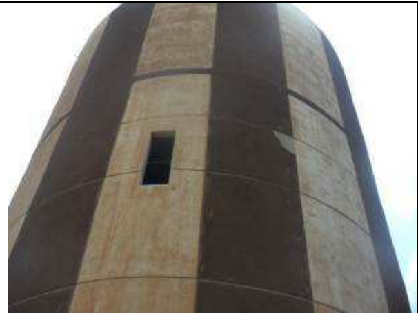
Photo 6 : arrachement d'enduits sur la cuve du château d'eau de l'université de Lomé
